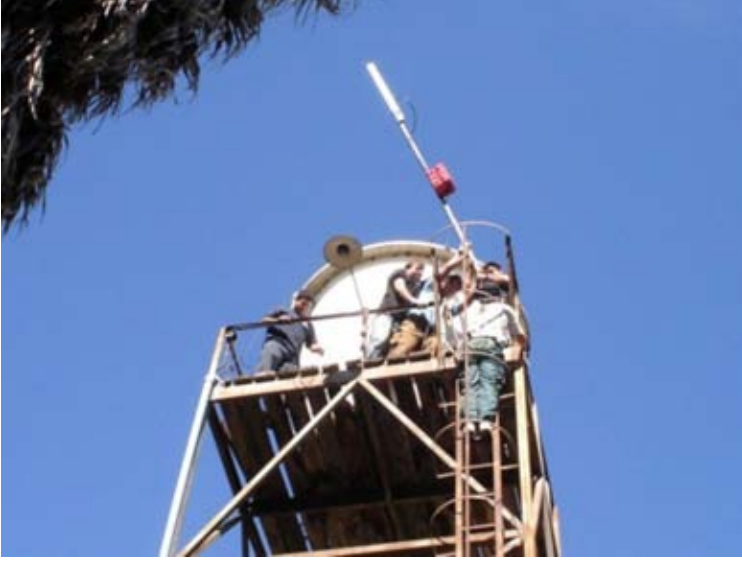
شكل 11.24: تركيب نقطة في أعلى برج للمياه في منطقة باتوكو Batuko لتوفير الإتصال بمركز الولوج البعيد في كابراتي Cabrati.
