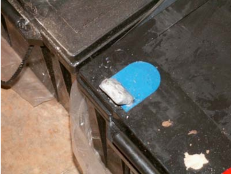
شكل 7.2: بطارية حمضية باستطاعة 200 أمبير. يظهر قطب البطارية السالب وقد انكسر أثناء النقل.
